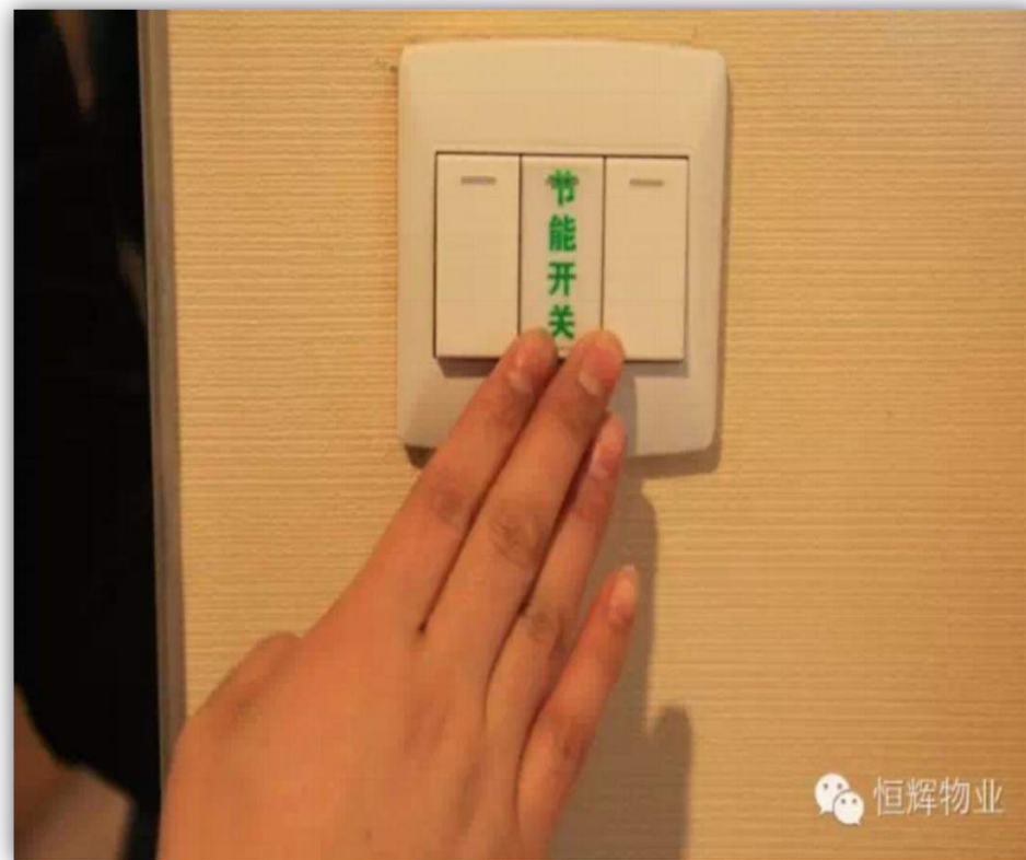
检查照明开关处于节能状态
